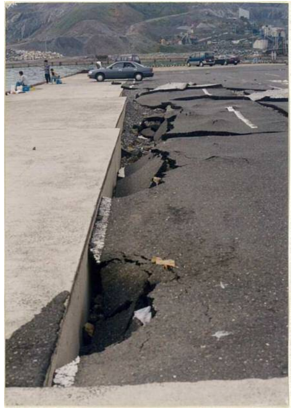
③道路の陥没(太刀浦34号道路)
