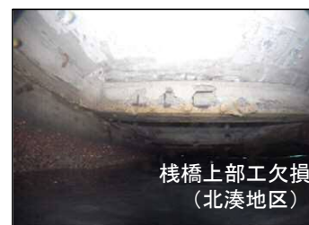
図 2-20 老朽化の状況
